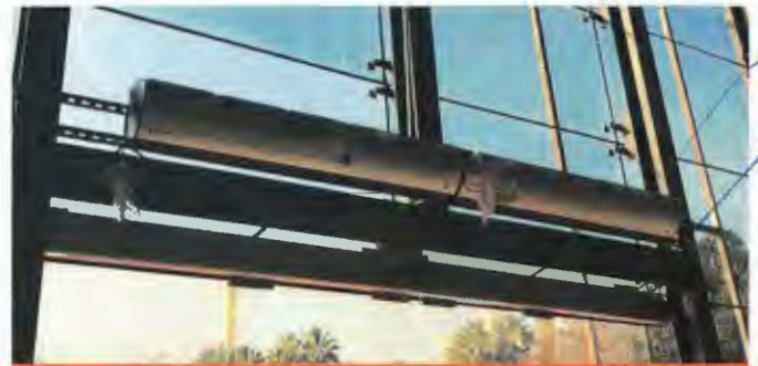
Cortinas de aire Nave Lewis
